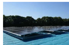
(右)万日山配水池太陽光発電設備(PPA)
