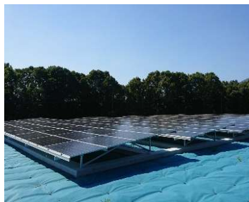
万日山配水池太陽光発電設備(PPA)
