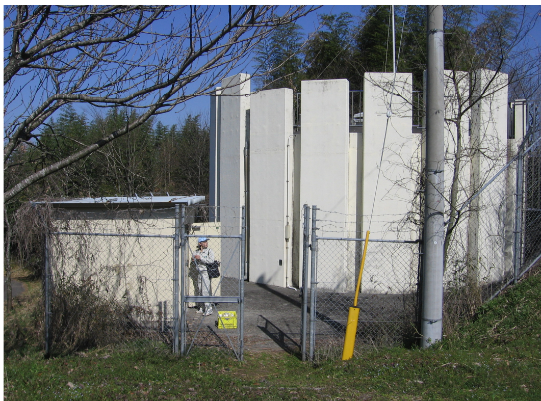
工業用水道配水池
