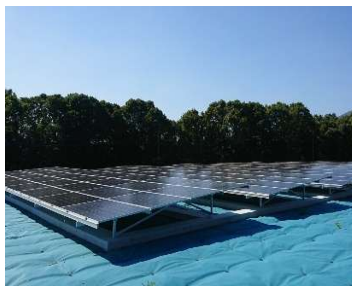
万日山配水池太陽光発電設備(PPA)
