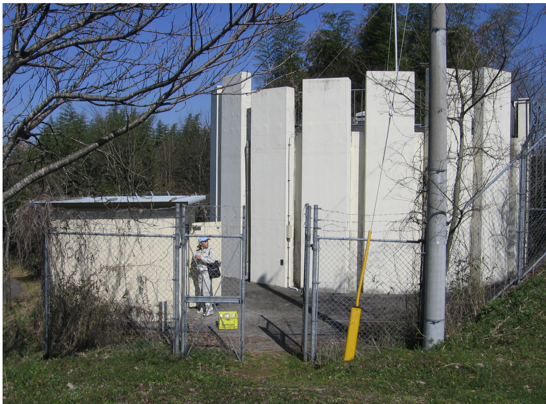
工業用水道配水池
