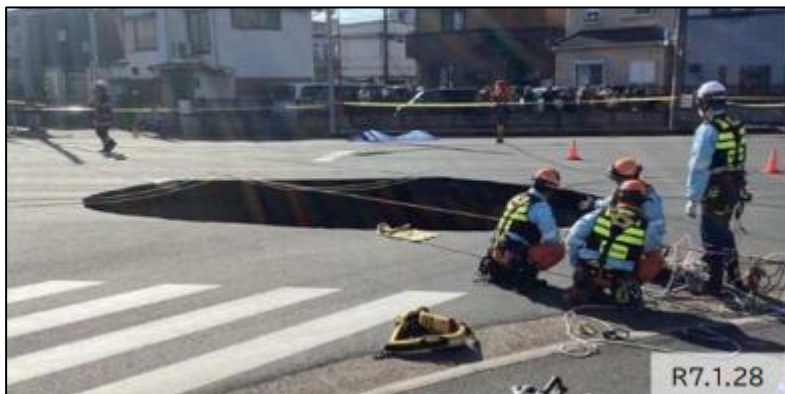
▲埼玉県八潮市の道路陥没事故
