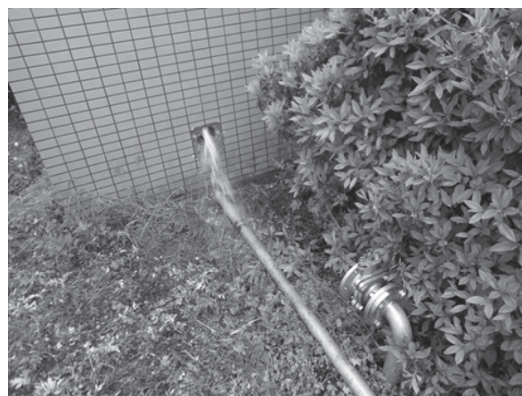
写真2-2-7 工業用水道施設 破損状況
