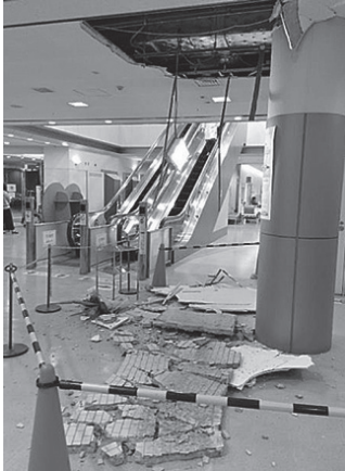
写真2-2-2 熊本市市民病院新館待合ホール天井材落下
