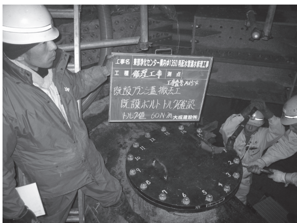
写真2-2-10 秋津町秋田の水道管の漏水による復旧状況
