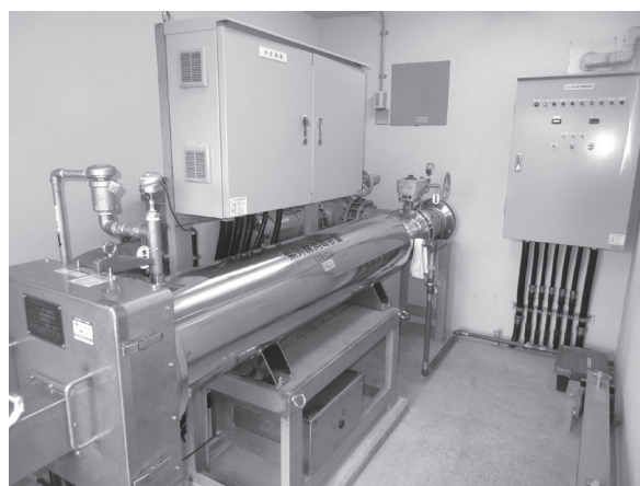
写真2-3-1 亀井水源地紫外線消毒装置
