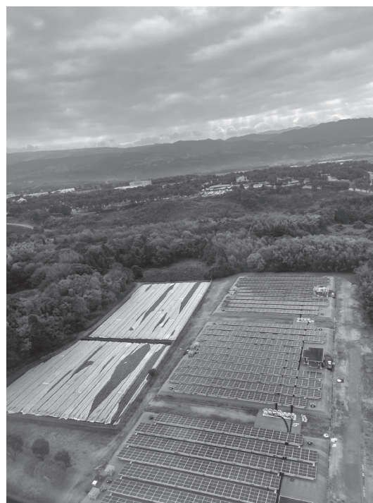
写真2-3-4 高遊原配水池の太陽光発電設備
