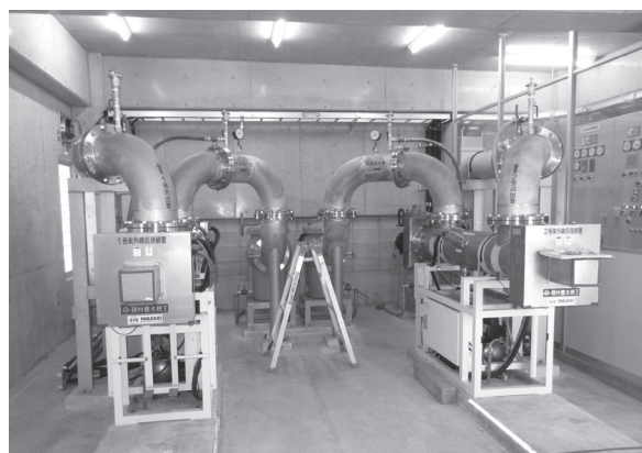
写真2-3-2 一本木水源地紫外線処理装置
