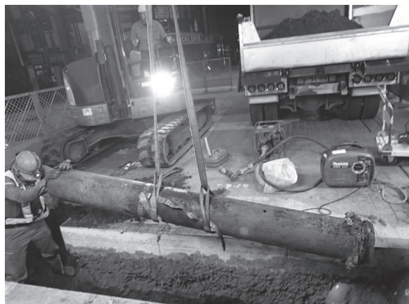
写真2-4-18 更新工事により取り除かれた老朽管
