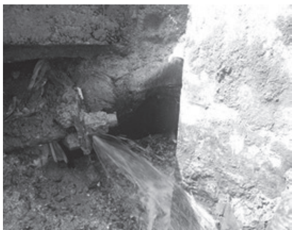
写真2-2-3 漏水する上水道φ800送水管
