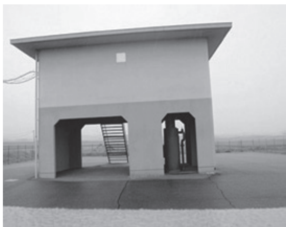
写真2-2-4 沼山津8号井の建物傾斜
