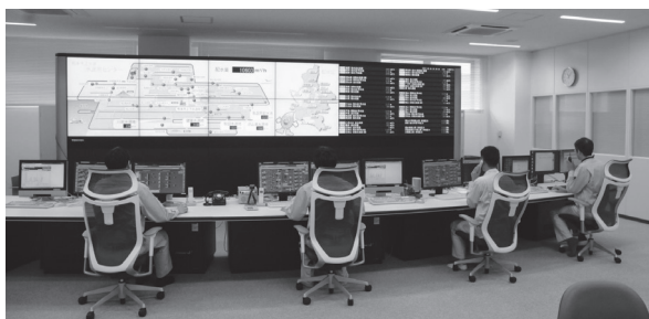
写真2-3-11 上下水道局3階水運用センター
