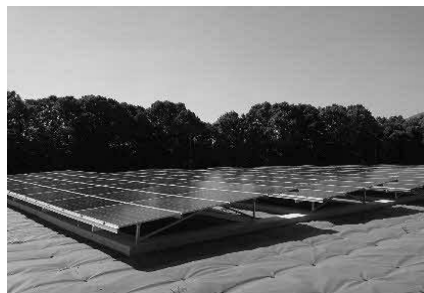
万日山配水池太陽光発電設備(PPA)
