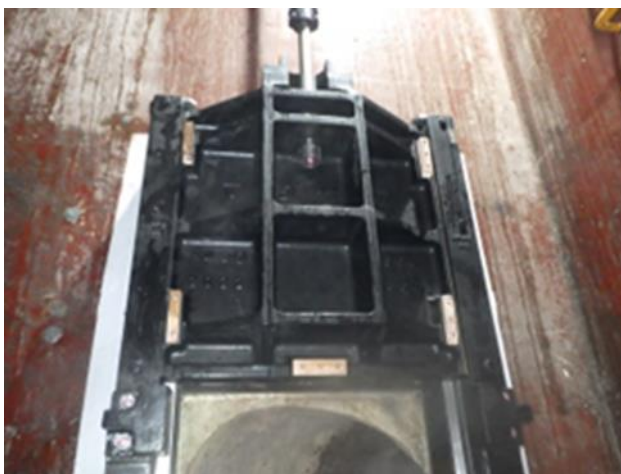
更新した流入ゲート設備 (坪井第二ポンプ場)
