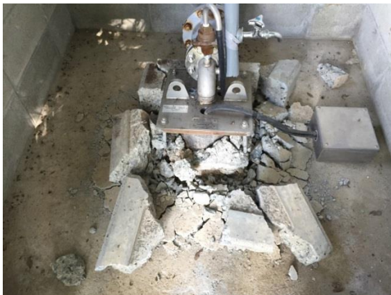
熊本地震による井戸ポンプの被害
