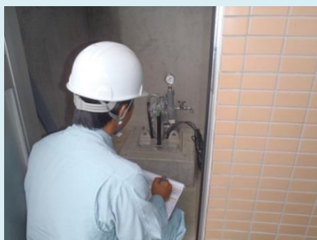
井戸ポンプの点検
