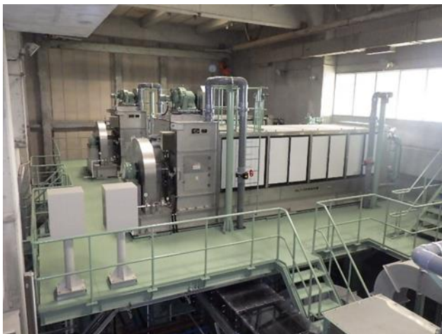
更新した汚泥脱水設備 (東部浄化センター)
