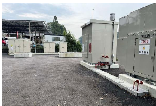
新規整備した一木4井 （井戸、制御盤、非常用発電設備）
