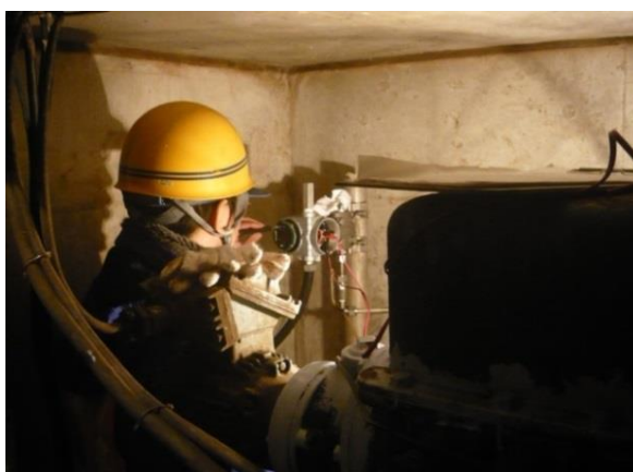
圧力計の点検
