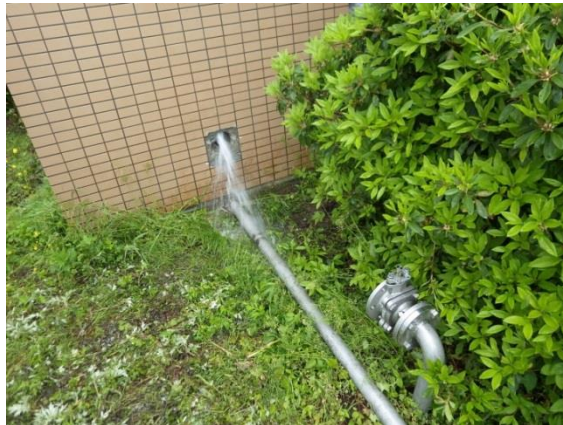
熊本地震による送水管の被害
