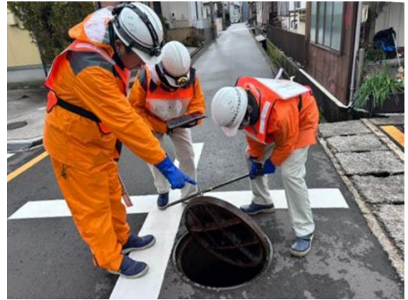
写真 3-4-3-2 下水道施設の被害調査(能登半島地震)
