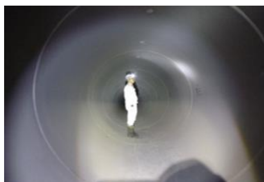
写真 4-3-4 雨水バイパス管
