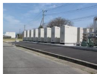
写真 4-3-12 消化ガス発電 (東部浄化センター)
