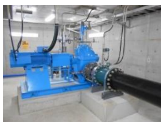
写真 4-3-11 小水力発電 (戸島送水場)
