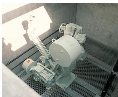
緊急遮断弁 震度6弱以上で作動し配水池からの 水の流失を防ぎます
