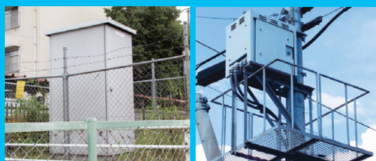
路上局A(電動弁制御所)
