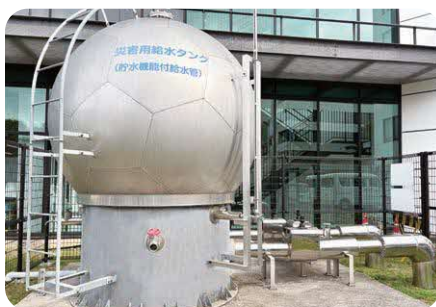
熊本市上下水道局前の貯水機能付給水管
