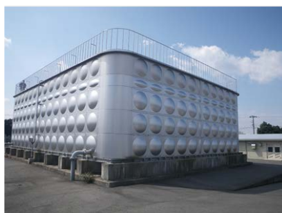
舞原配水場（城南）
