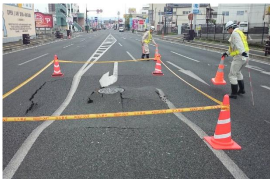
写真 4-3-1 熊本地震時の被害状況 (緊急輸送路内陥没の様子)
