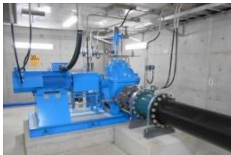
写真 4-3-7 小水力発電（戸島送水場）
