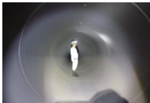
写真 4-3-2 雨水バイパス管
