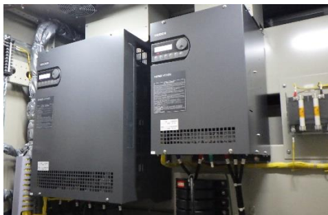
写真 4-3-5 省電力機器（庄口水源地）
