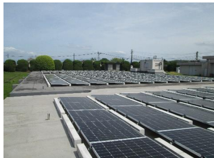
写真 4-3-6 太陽光発電（徳王配水池）
