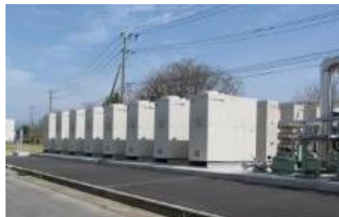
写真 4-3-8 消化ガス発電（東部浄化センター）
