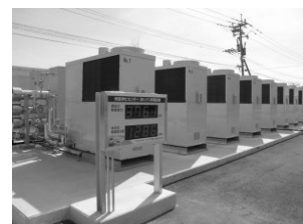
消化ガス発電設備
