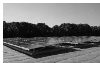
万日山配水池太陽光発電設備(PPA)
