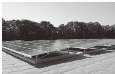
万日山配水池太陽光発電設備(PPA)
