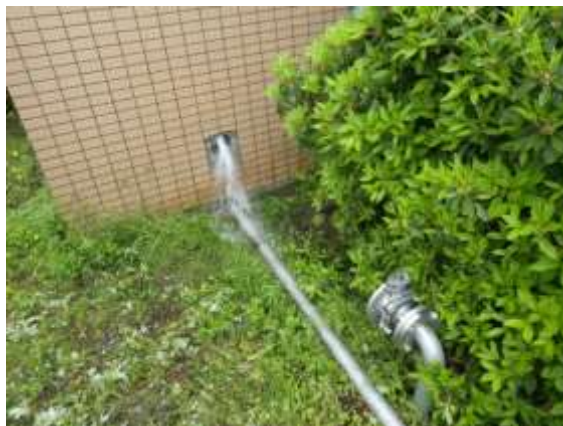
熊本地震による送水管の被害
