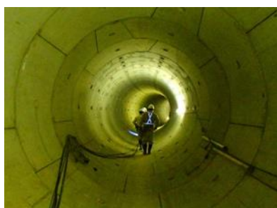
雨水貯留管(加勢川第6排水区)
