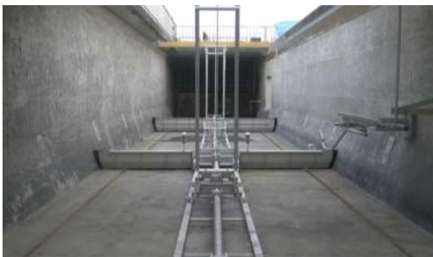
更新した汚泥掻き寄せ機
