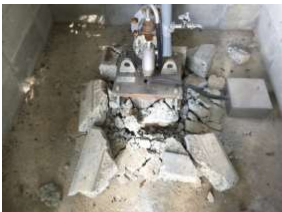
熊本地震による井戸ポンプの被害
