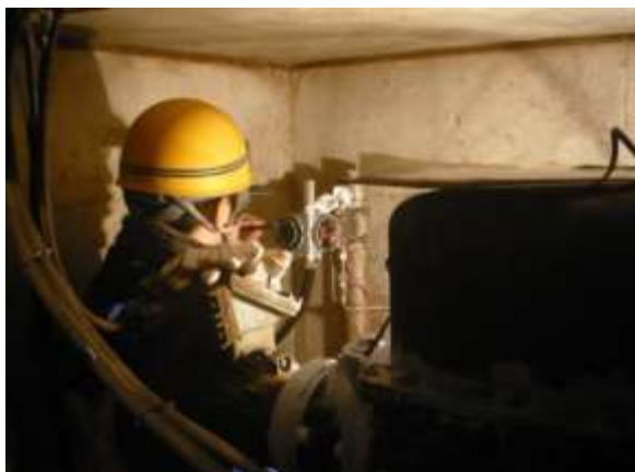
圧力計の点検
