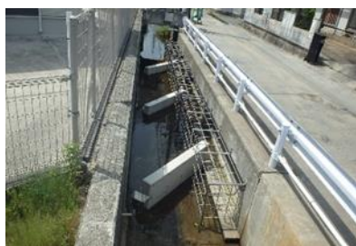
分水施設(井芹川第9排水区)
