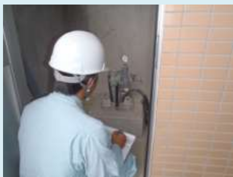
井戸ポンプの点検
