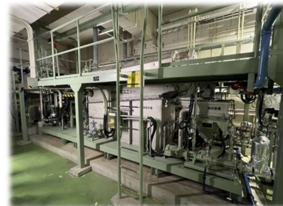
南部浄化センター 繊維利活用システム設置 (汚泥処理の効率化)
