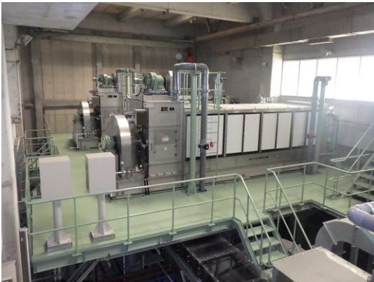
更新した下水道施設(汚泥脱水設備)
