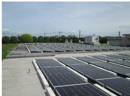
写真 4-3-6 太陽光発電（徳王配水池）
