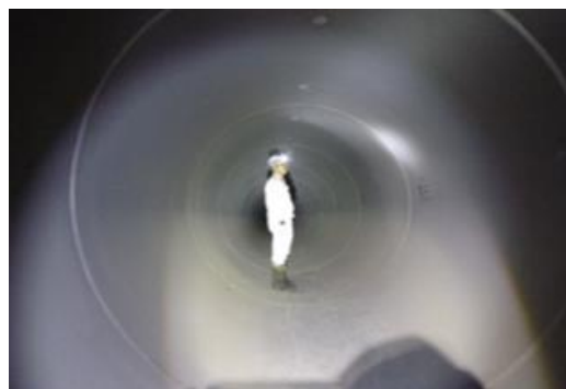
写真 4-3-2 雨水バイパス管
