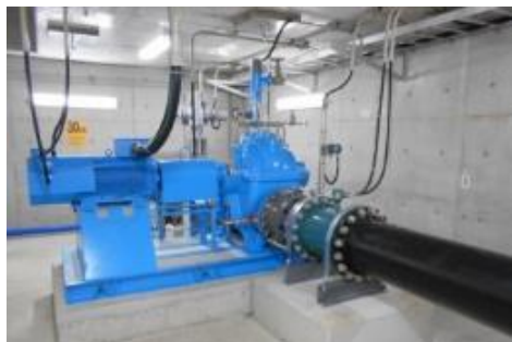
写真 4-3-7 小水力発電（戸島送水場）
