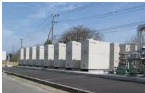
写真 4-3-8 消化ガス発電（東部浄化センター）
