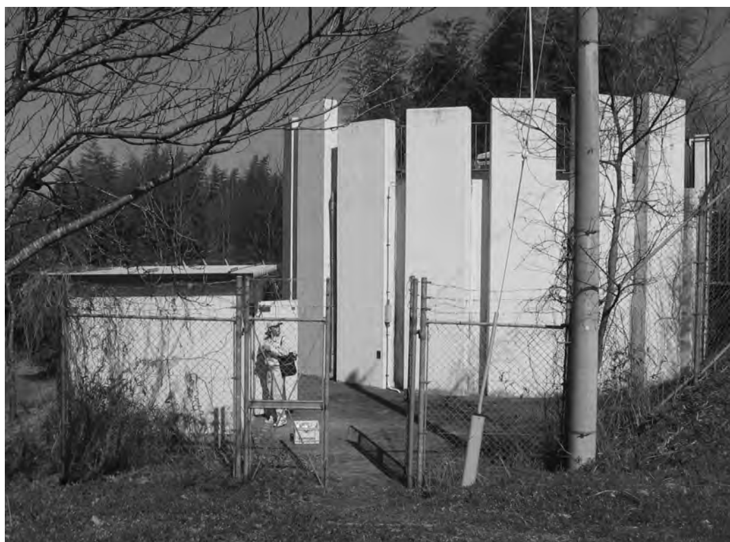
工業用水道配水池
