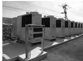
消化ガス発電設備 （上）中部浄化センター消化ガス発電機（エンジン） （下）東部浄化センター消化ガス発電設備（外観）
